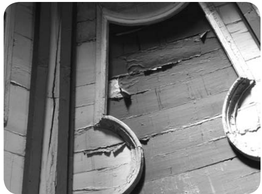
Estado de la Bóveda de la Capilla Sacramental
