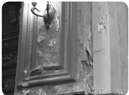
Estado de las paredes del Templo
